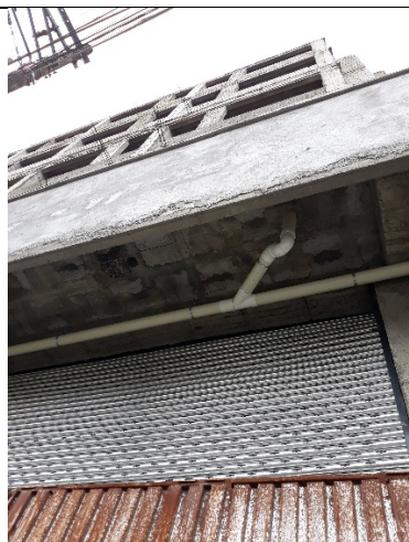
Figura 55 , Estado actual de instalaciones de desagüe.
