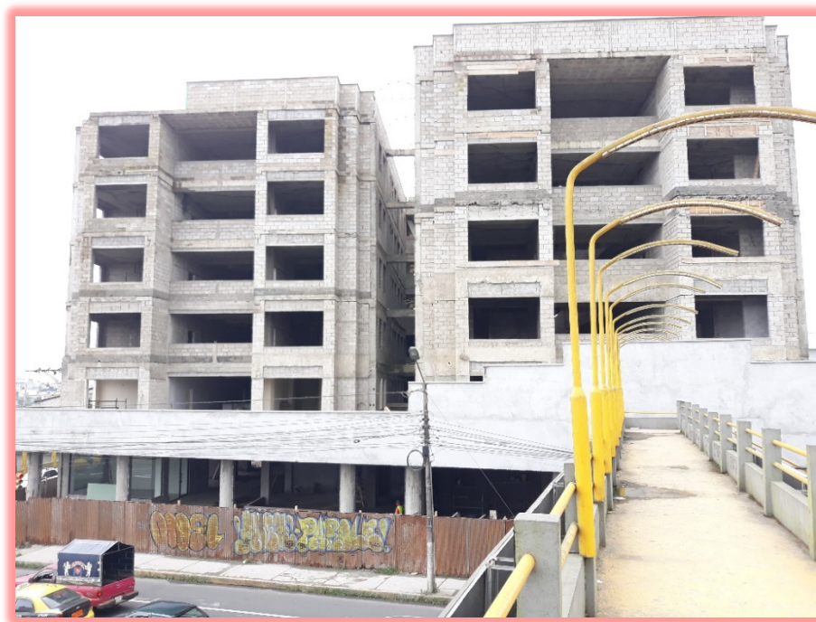
Figura 49, Visual externa del puente peatonal hacia la fachada frontal del edificio Torres Zermatt.
