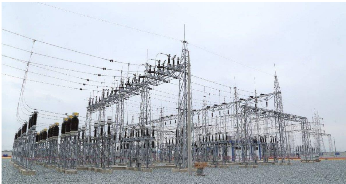
Figura 2. Subestación Durán a 230 / 69 kV
