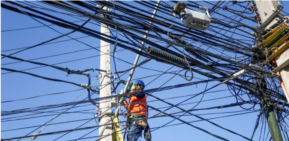
Figura 5. Estado de las redes físicas de Telecomunicaciones en la ciudad de Quito
