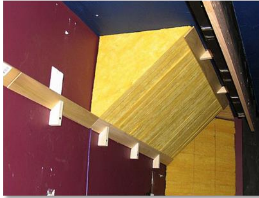
Figura 30. Aislamiento con espuma de poliuretano en esquinas.
