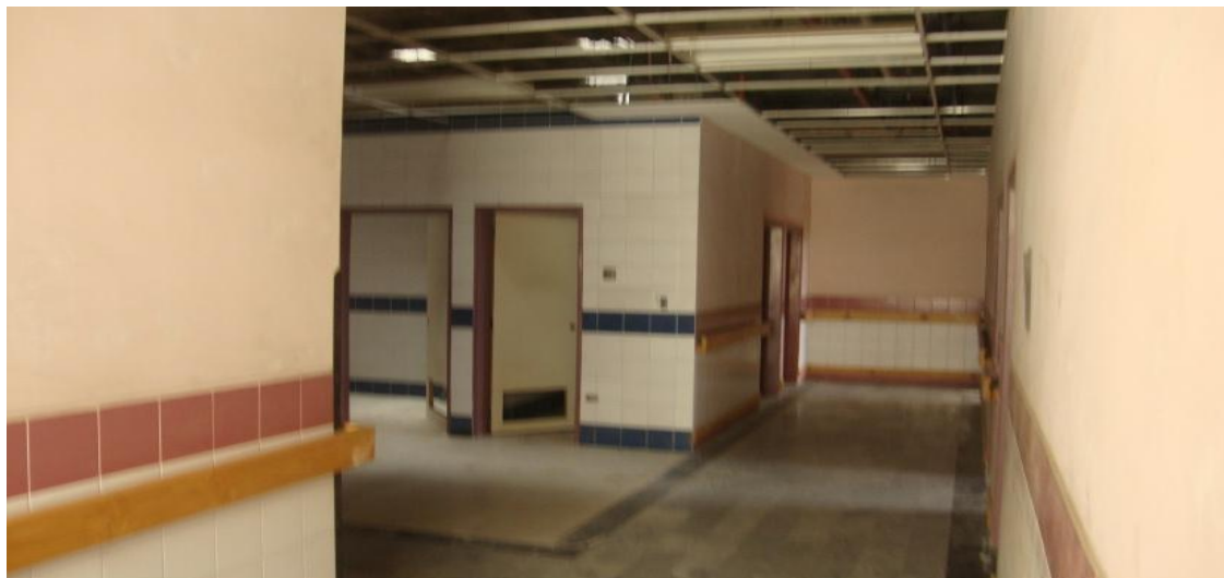
Figura 14: Instalación interna Hospital Básico IESS - Guaranda Tomado de Hospital Humberto Pozo (2016)
