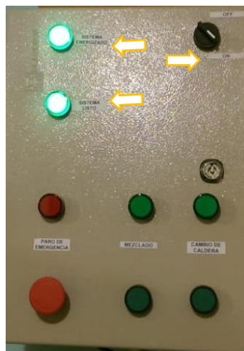
Figura 47 Sistema Energizado y Listo.
