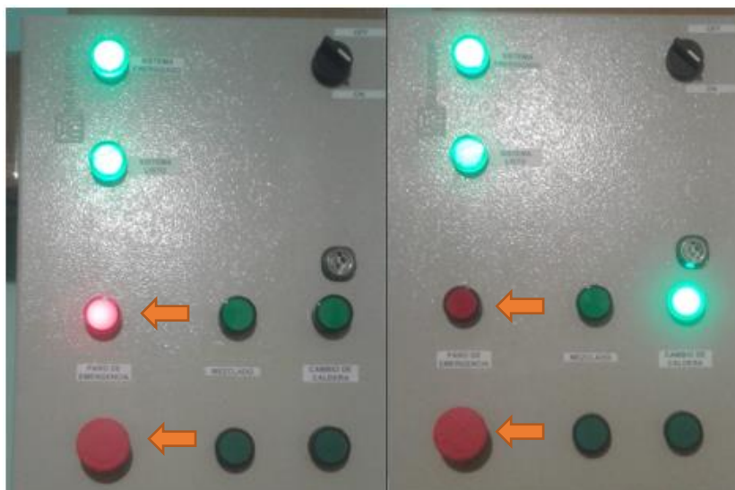
Figura 39 Paro de emergencia
