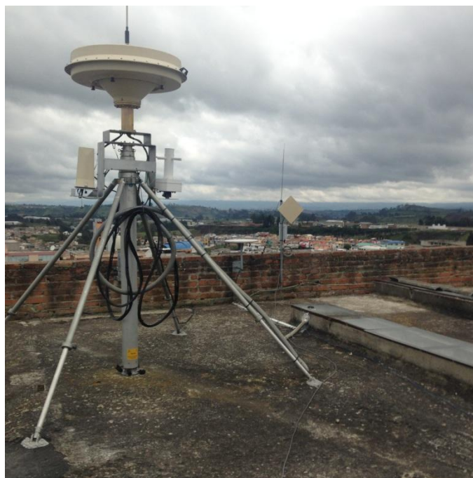
Figura 27. Antena R&S HE500 Edificio del Municipio de Tulcán - Tulcán
